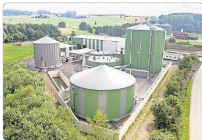
Bei Vollastbetrieb können in der Bioabfallvergärungsanlage Hochfranken jährlich bis zu 30000 Tonnen Bioabfall verarbeitet werden. Das produzierte Biogas treibt Gasmotoren an, die jährlich rund 19 500 Megawattstunden Strom erzeugen. Durch das bestehende Mikroschiff werden sowohl der erzeugte Strom als auch die Abwärme vollständig und lokal genutzt.
